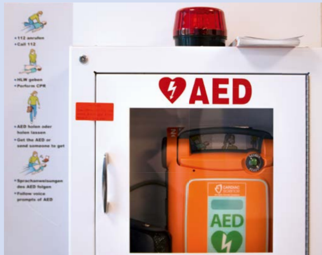
► Auch im Verwaltungsgebäude 16.11 befindet sich ein Automatisierter Externer Defibrillator. (Foto: Lukas Piel)
