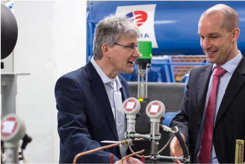
► Johannes Jennissen und Dr. Sönke Biel an der Kältemaschine in der Technikzentrale 1 (Gebäude 21.01). (Foto: Lukas Piel)
