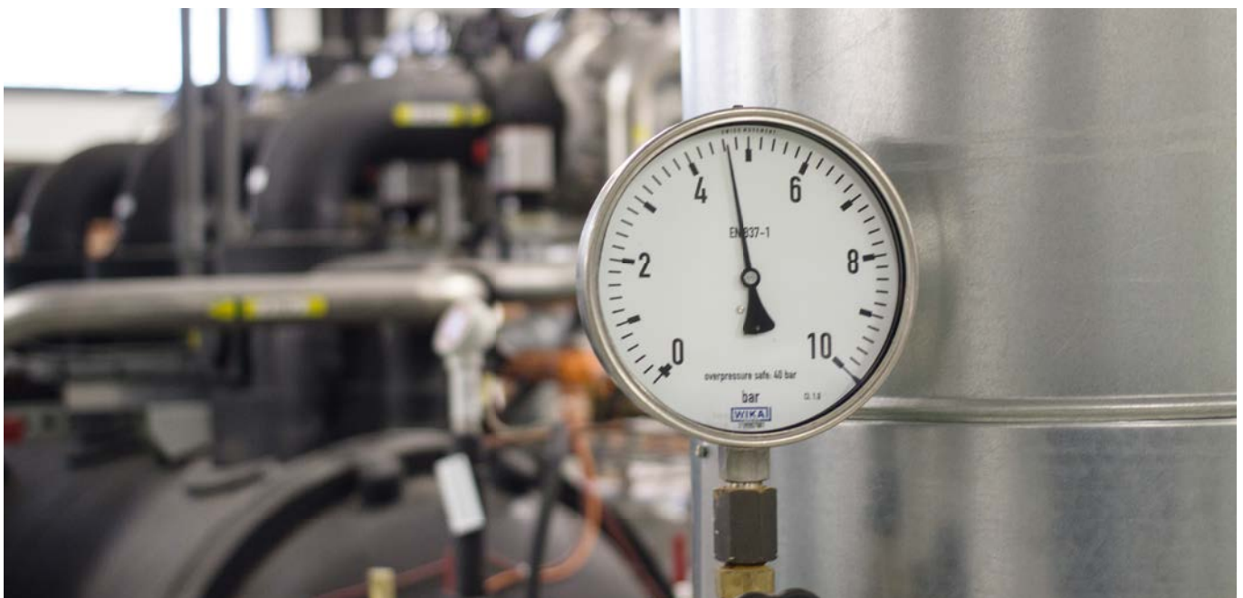
► Druckanzeiger in der Technikzentrale 1. Sie ist das „anlagentechnische Kernstück“ der Heinrich-Heine-Universität. Die Planung für die Modernisierung und die Neubauten begann 2009 im Zuge der „Hochschulstandortentwicklungsplanung“. (Foto: Lukas Piel)
